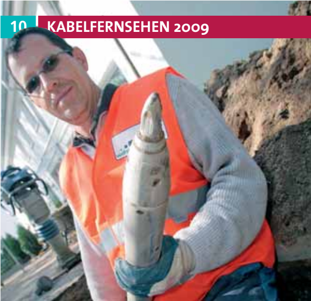
Spezialistin für unterirdische und zielgenaue Erdrohren ist die Erdrakete. Sie wird von einem Baustellenkompressor angetrieben
