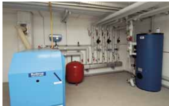
Im Keller befindet sich die moderne und Energie sparende Heizungsanlage
